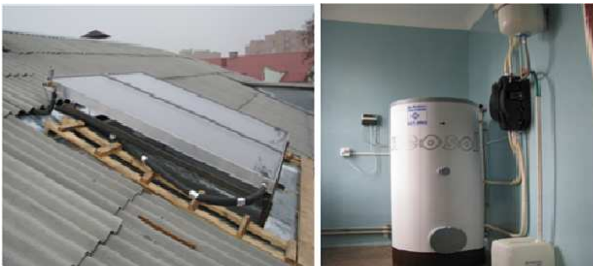
Rys.9. Zdjęcie przedstawiające kolektory zamontowane na dachu, oraz instalację solarną zamontowaną w akademiku Połtawskiej Akademii Rolniczej
